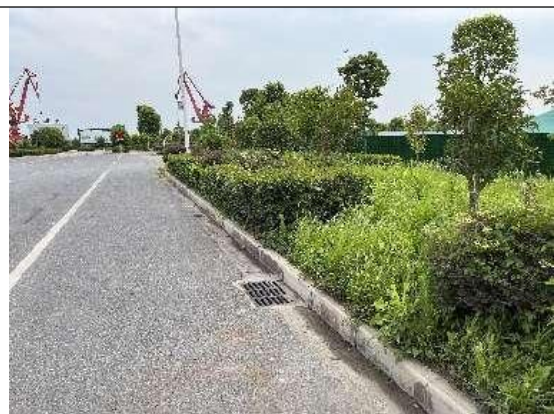
堆场区雨水排水管（雨水口）
